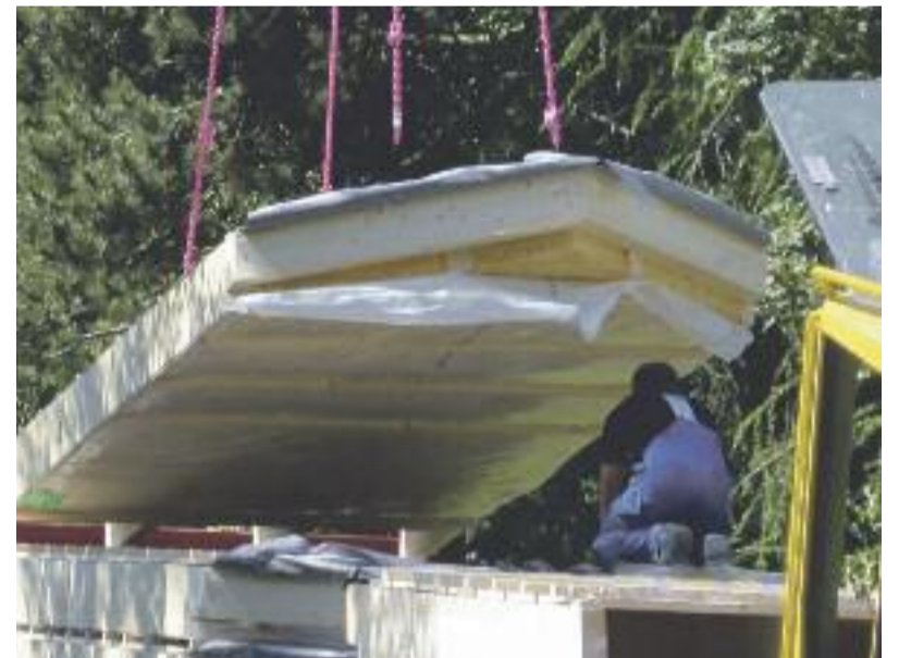
Für die Verhinderung solcher Fahrlässigkeiten ist der Arbeitgeber verantwortlich – auch bei Temporär-Mitarbeitenden. BILD ZPK
